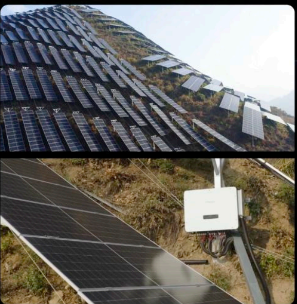
Falownik sieciowy Hangzhou, Chiny, Pojemność 40MWp
