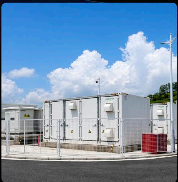
5000kWh Kontener ESS Zhejiang, Chiny, Pojemność 400MWh
