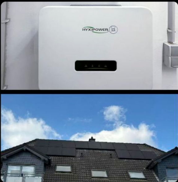
Hybrid-Wechselrichter & Hochvolt-Batterie Rheinland-Pfalz, Deutschland, Anlagenleistung 50 kW
