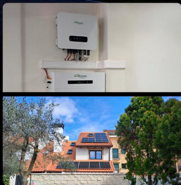
Hybrid-Wechselrichter, Hochvolt-Batterie Madrid, Spanien, Anlagenleistung 5,28 kW
