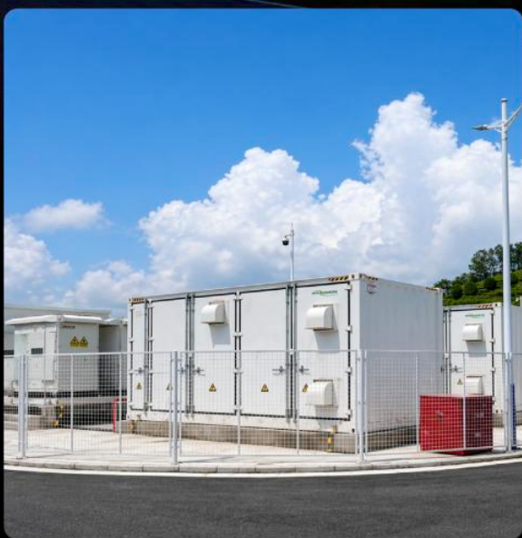
5000-kWh-Container-Energiespeicher Zhejiang, China, Anlagenleistung 400 MWh
