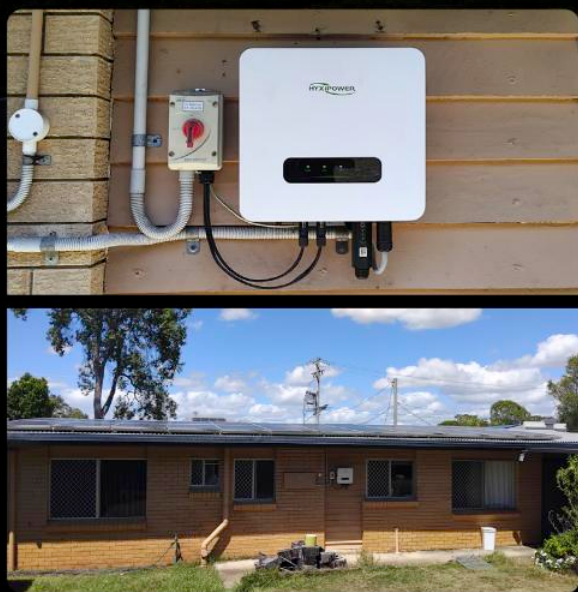
Hybrid-Wechselrichter Brisbane, Australien, Anlagenleistung 6,6 kW
