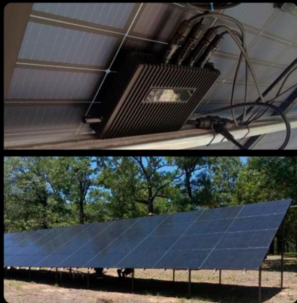
Mikrowechselrichter Arkansas, USA, Anlagenleistung 11,6 kW
