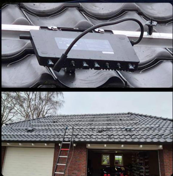
Mikrowechselrichter Drenthe, Niederlande, Anlagenleistung 7,9 kW
