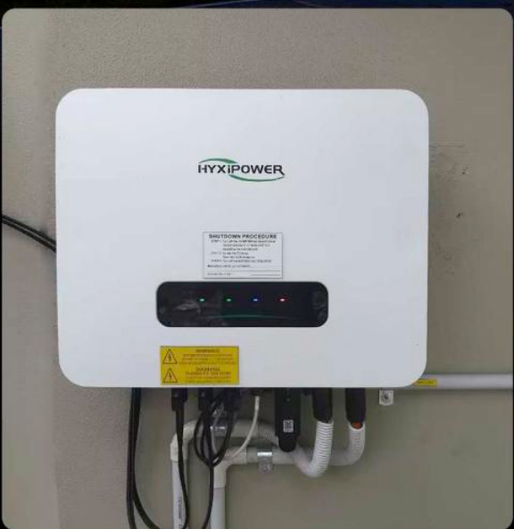
Hybrid-Wechselrichter Queensland, Australien, Anlagenleistung 6,6 kW
