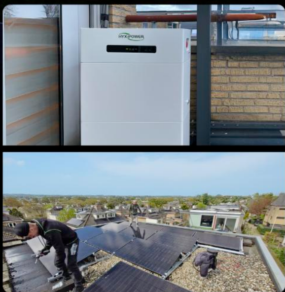
Hybrid-Wechselrichter, Hochvolt-Batterie Rotterdam, Niederlande, Anlagenleistung 10 kW
