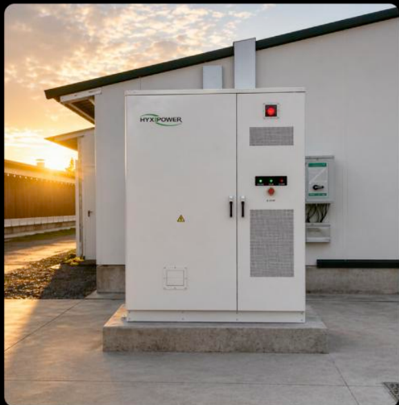
C&I-Energiespeicher 105 kW / 232 kWh Spanien, Anlagenleistung 100 kW / 215 kWh
