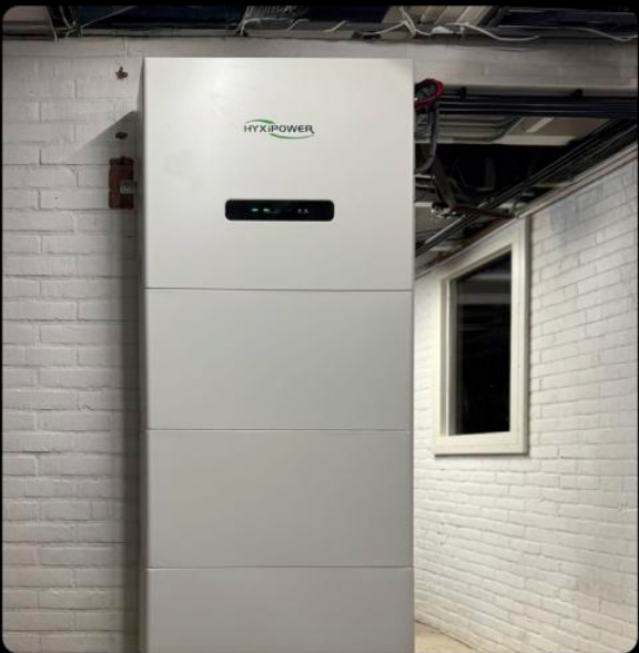
All-in-One-Energiespeichersystem Overijssel, Niederlande, Anlagenleistung 12 kW / 20 kWh
