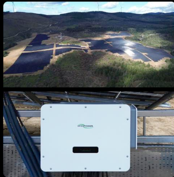
String Inverter Çanakkale İli, Türkiye, Capacity 29MW
