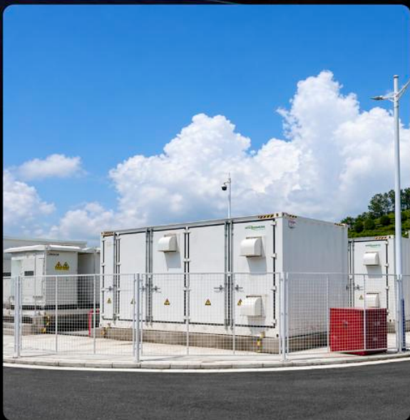
Sistema de almacenamiento de energía (ESS) en contenedor de 5000 kWh Zhejiang, China, capacidad de 400 MWh
