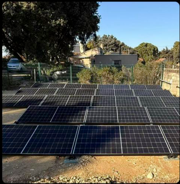
Microinversor Orange, Francia, capacidad: 9 kW
