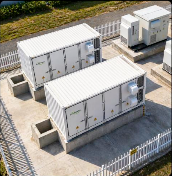
Sistema de almacenamiento de energía (ESS) en contenedor de 5000 kWh Zhejiang, China, capacidad de 5 MW/10 MWh
