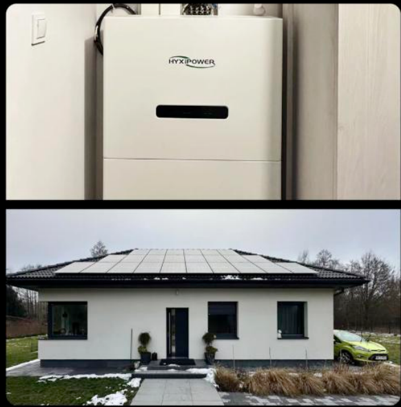
Sistema de almacenamiento de energía (ESS) «todo en uno» Mazovia, Polonia, capacidad: 10 kW
