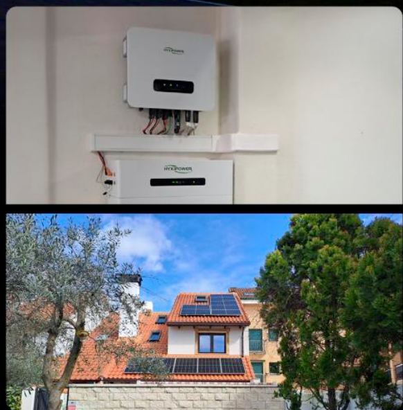
Inversor híbrido, batería de alta tensión Madrid, España, capacidad: 5,28 kW
