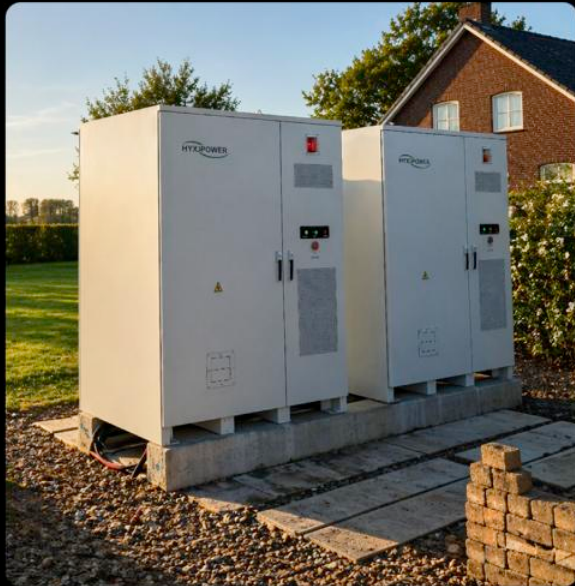
Sistema de almacenamiento energético (ESS) para el sector comercial e industrial de 105 kW/232 kWh Países Bajos, capacidad de 200 kW/430 kWh
