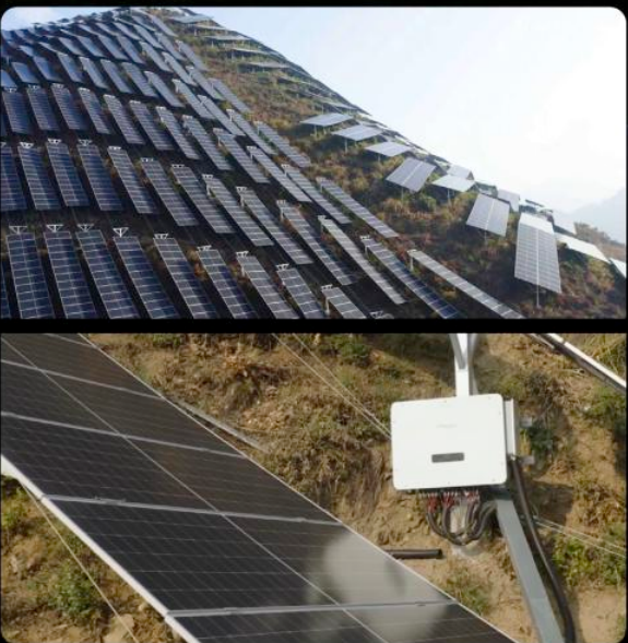
Inversor String Hangzhou, China, capacidad de 40 MWp
