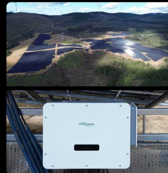
Inversor de String Çanakkale İli, Türkiye, Capacidade 29MW
