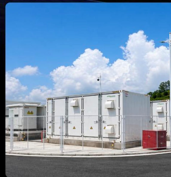
5Sistema de Armazenamento de Energia em Contêineres de 5 MWh Zhejiang, China, Capacidade 400MWh
