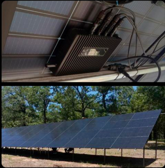
Microinversor Arkansas, USA, Capacidade 11.6kW
