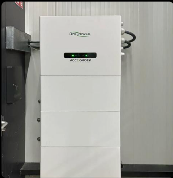
Sistema de Armazenamento de Energia Integrado Overijssel, Netherlands, Capacidade 12kW/20kWh
