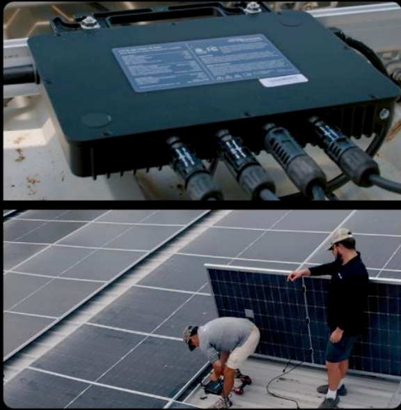
Microinversor Texas, USA Capacidade 117kW
