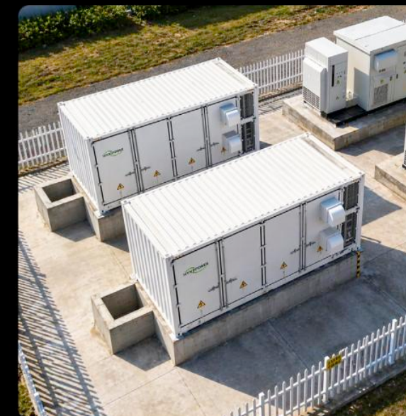
5Sistema de Armazenamento de Energia em Contêineres de 5 MWh Zhejiang, China, Capacidade 5MW/10MWh
