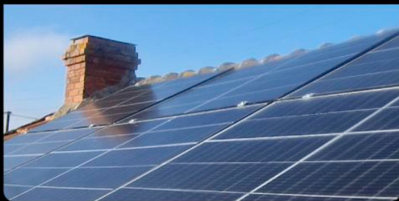
Microinversor Île-de-France, France, Capacidade 2.46kW
