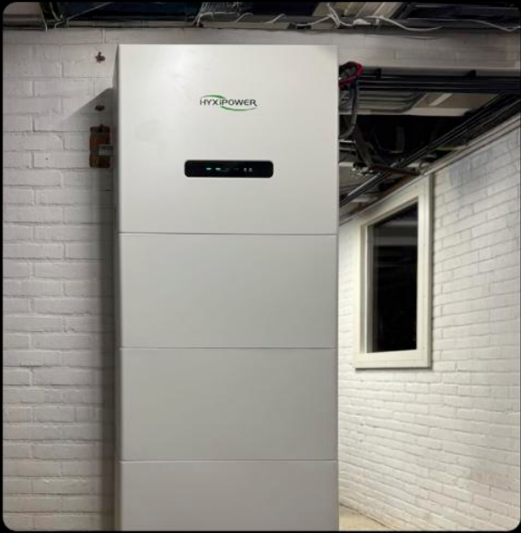
Sistema de Armazenamento de Energia Integrado Overijssel, Netherlands, Capacidade 12kW/20kWh
