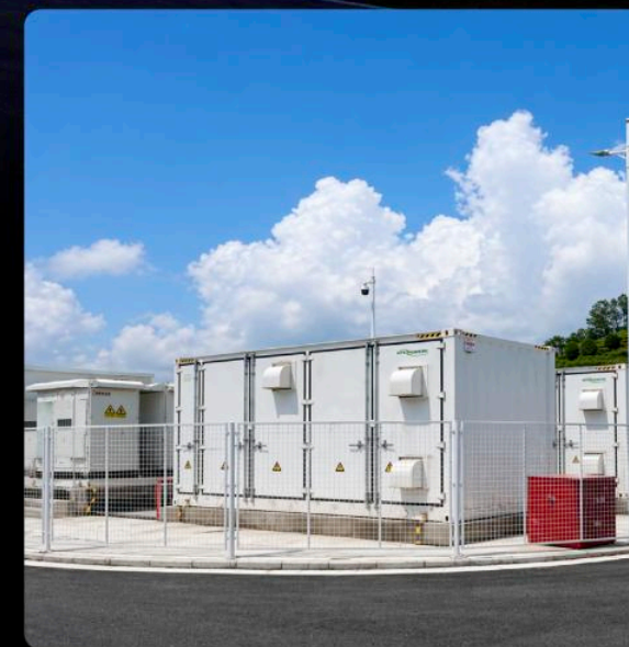
5000-kWh-Container-Energiespeicher Zhejiang, China, Anlagenleistung 400 MWh
