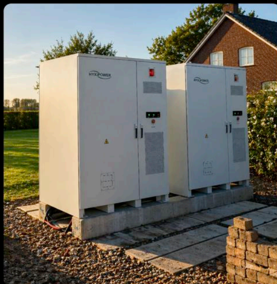
C&I-Energiespeicher 105 kW / 232 kWh Niederlande, Anlagenleistung 200 kW / 430 kWh
