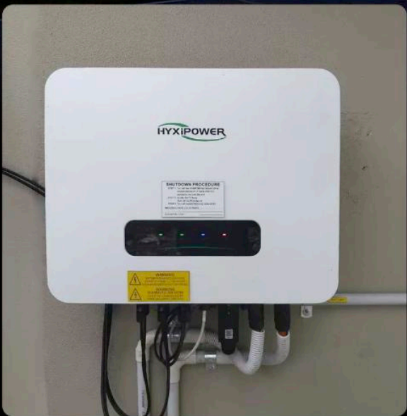
Hybrid-Wechselrichter Queensland, Australien, Anlagenleistung 6,6 kW
