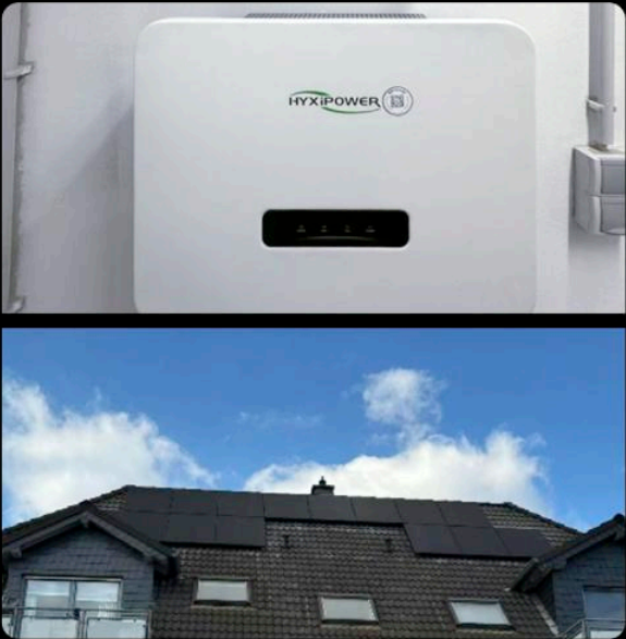
Hybrid-Wechselrichter & Hochvolt-Batterie Rheinland-Pfalz, Deutschland, Anlagenleistung 50 kW
