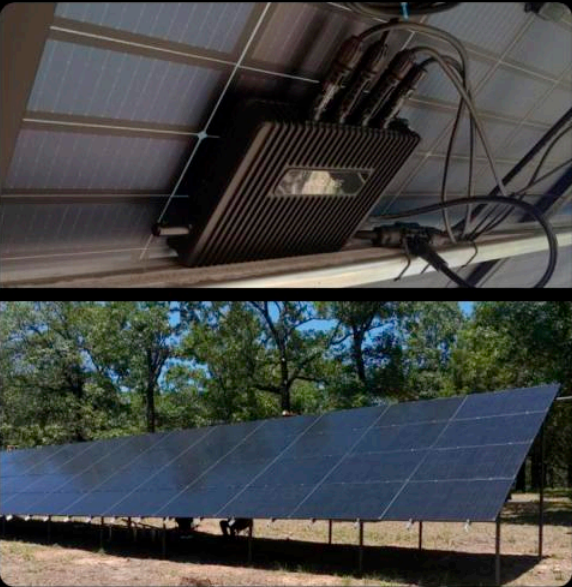
Mikrowechselrichter Arkansas, USA, Anlagenleistung 11,6 kW
