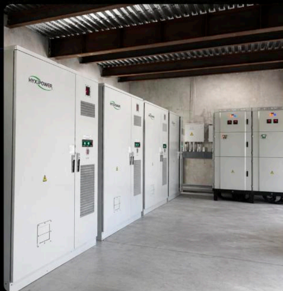
C&I-Energiespeicher 105 kW / 232 kWh Myanmar, Anlagenleistung 500 kW / 1075 kWh
