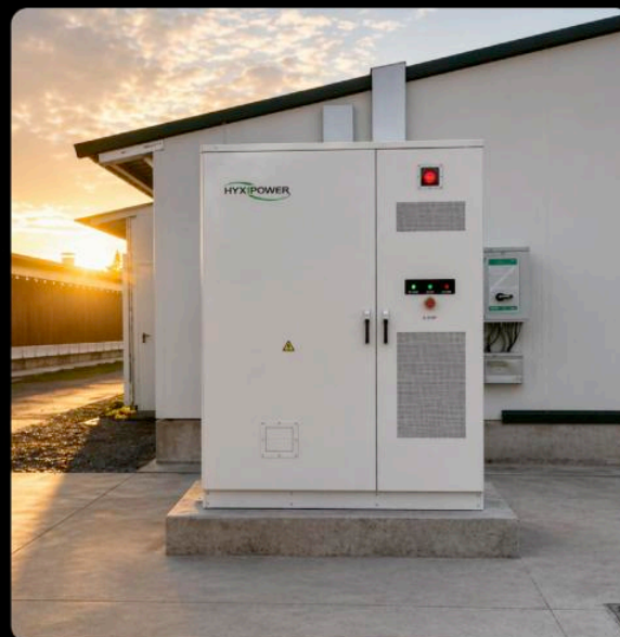
C&I-Energiespeicher 105 kW / 232 kWh Spanien, Anlagenleistung 100 kW / 215 kWh
