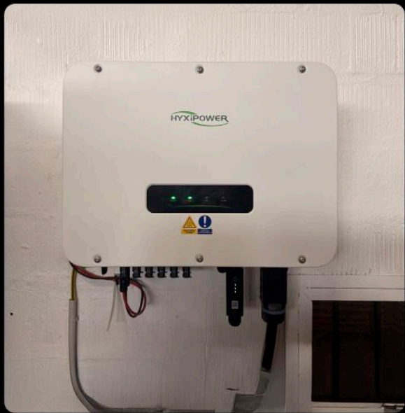
Mikrowechselrichter Drenthe, Niederlande, Anlagenleistung 7,9 kW
