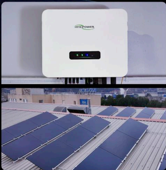
Hybrid-Wechselrichter Barcelona, Spanien, Anlagenleistung 25 kW
