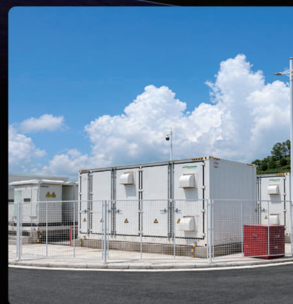
Hệ thống lưu trữ năng lượng dạng container 5MWh Zhejiang, China, Công suất 400MWh
