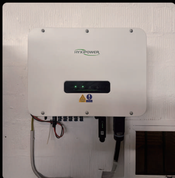
Biến tần vi mô Drenthe, Netherlands, Công suất 7.9kW
