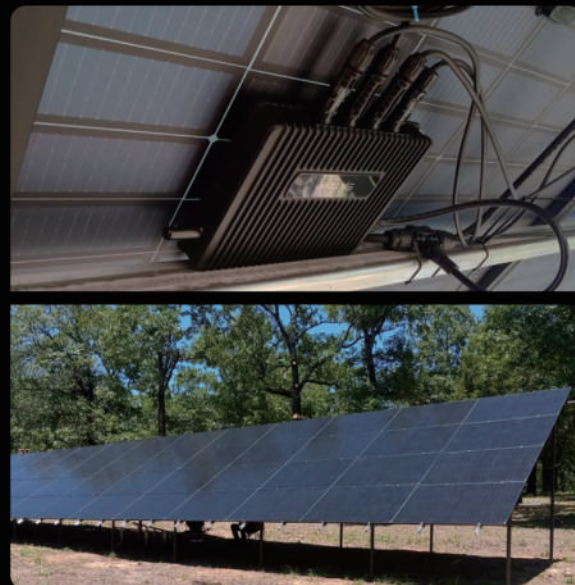
Biến tần vi mô Arkansas, USA, Công suất 11.6kW
