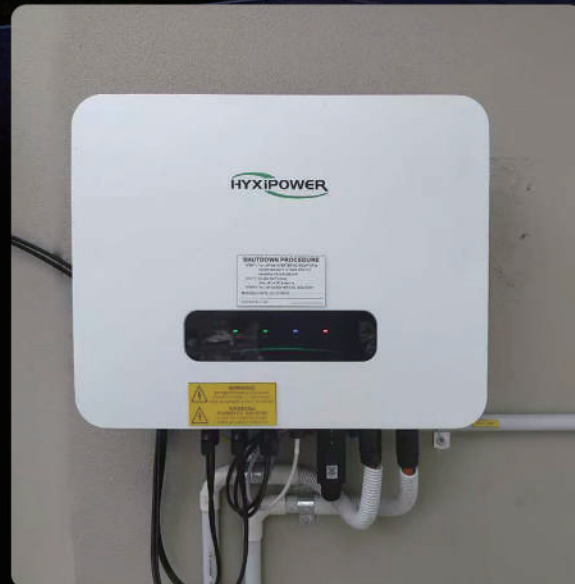
Biến tần lai Queensland, Australia, Công suất 6.6kW
