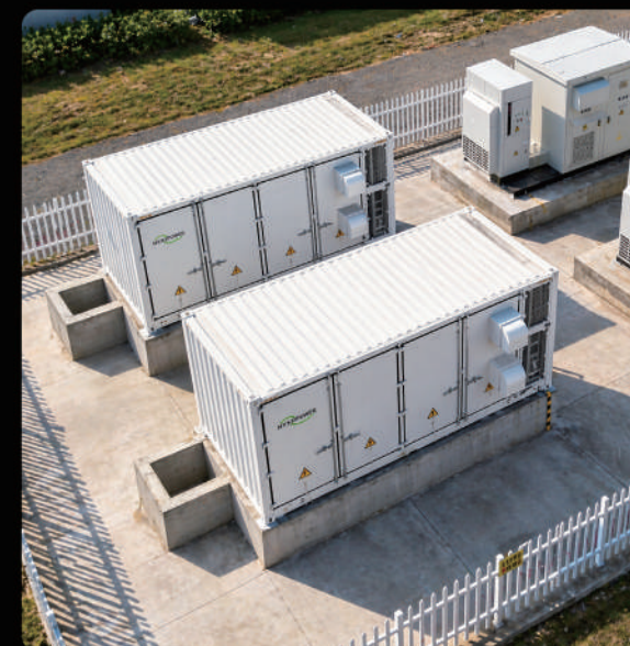
Hệ thống lưu trữ năng lượng dạng container 5MWh Zhejiang, China, Công suất 5MW/10MWh
