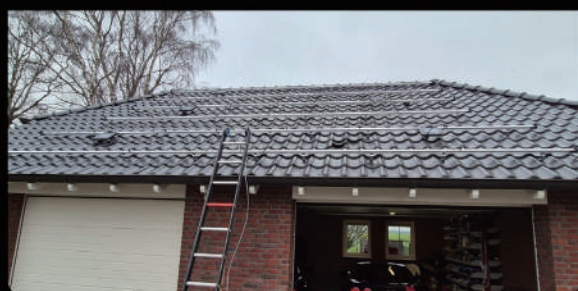
Biến tần vi mô Drenthe, Netherlands, Công suất 7.9kW
