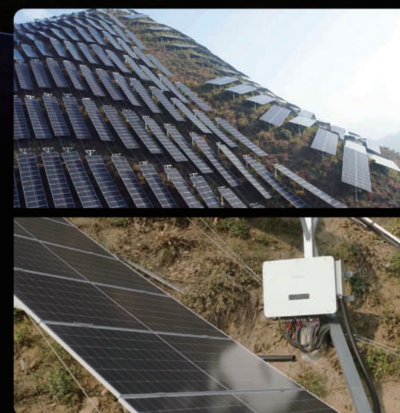
Biến tần chuỗi Hangzhou, China, Công suất 40MWp
