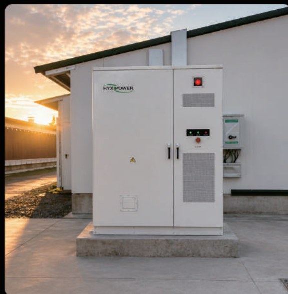
105kW/232kWh C&I ESS Spain, Công suất 100kW/215kWh
