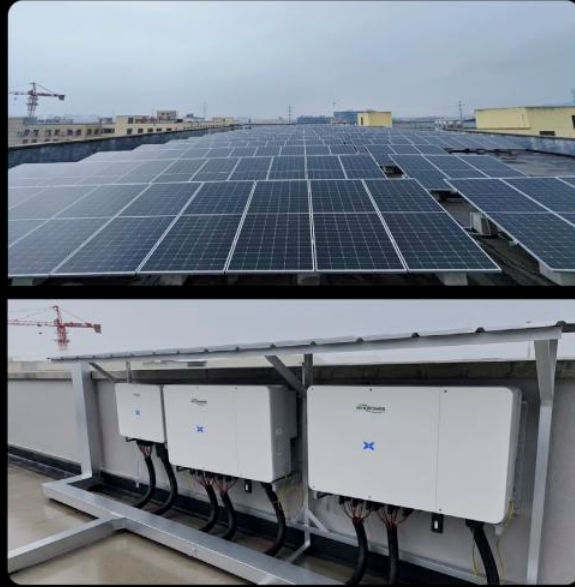
50kW、110kW 组串逆变器 中国浙江 规模 2.51MWp
