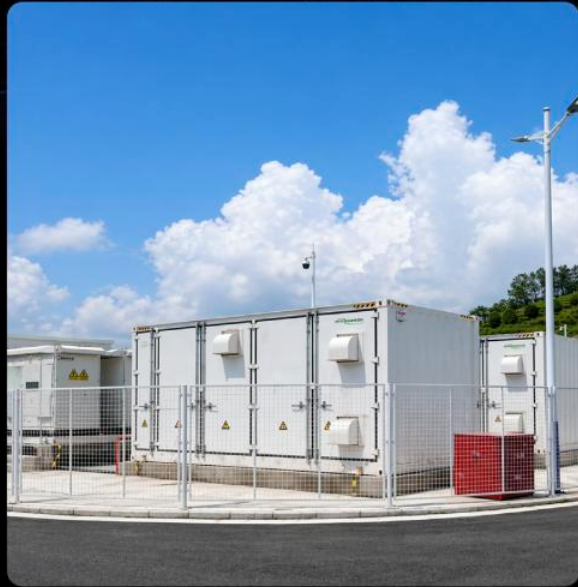
5MWh 集装箱储能 中国浙江 规模 200MW/400MWh
