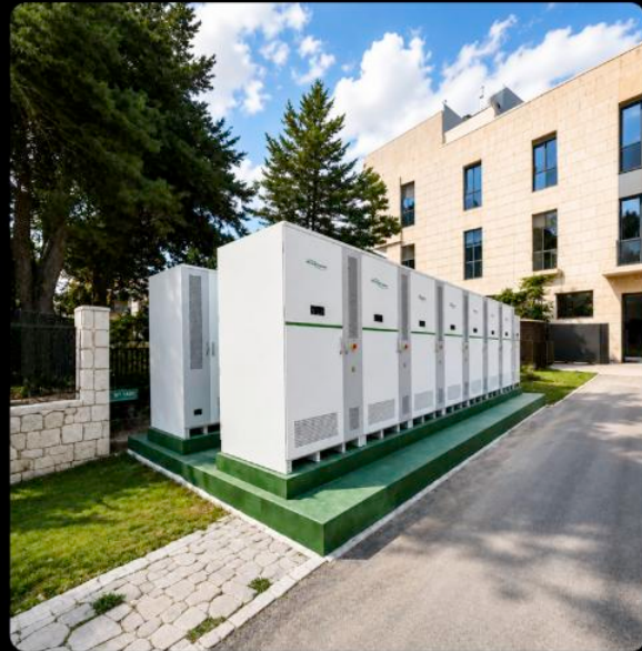
105kW/232kWh 一体柜 中国广东 规模 2.32MW/4.64MWh
