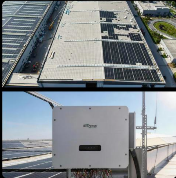
250kW、320kW 组串逆变器 中国浙江 规模 35MWp
