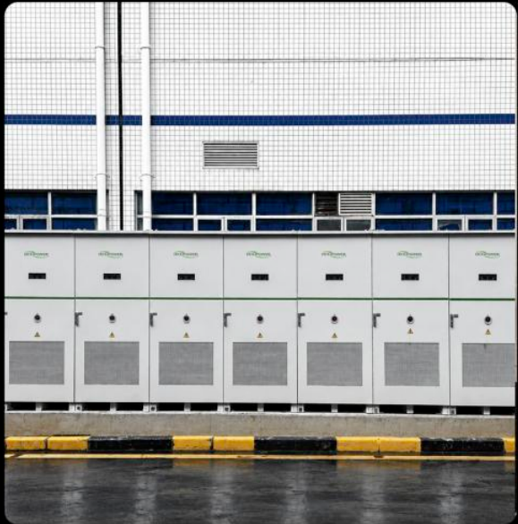
105kW/232kWh 一体柜 中国广东 规模 3.25MW/7.19MWh
