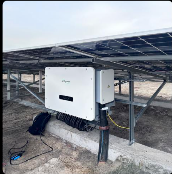
320kW 组串逆变器 中国山东 规模 6MWp
