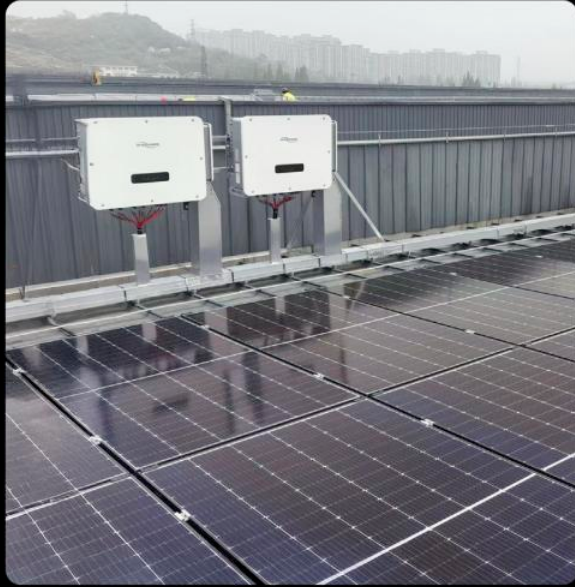
50kW、110kW组串逆变器 中国浙江 规模 4MWp
