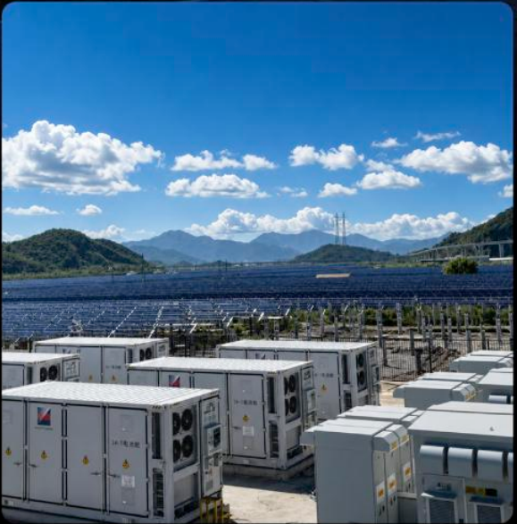
5MWh 集装箱储能 中国浙江 规模 15MW/30MWh
