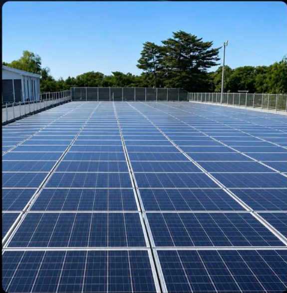
50kW、110kW组串逆变器 中国浙江 规模 3.67MWp
