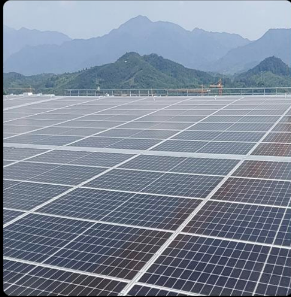
50kW、110kW 组串逆变器 中国浙江 规模 4MWp
