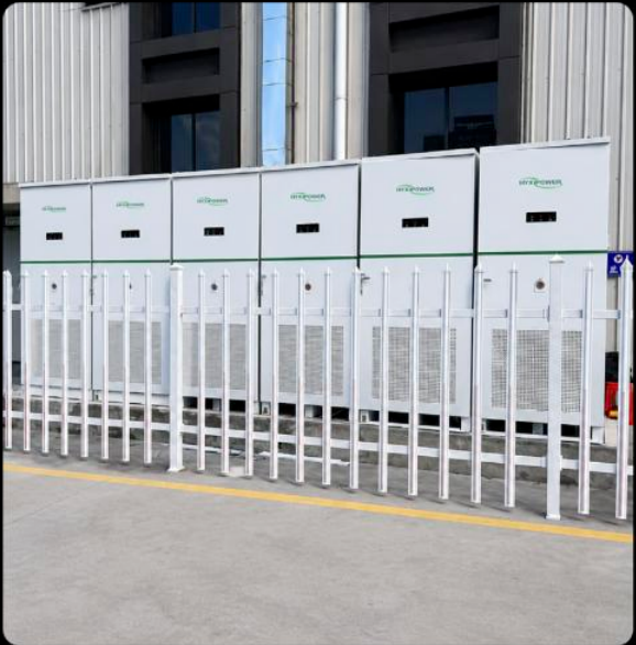
105kW/232kWh 一体柜 中国浙江 规模 2.13MW/4.44MWh
