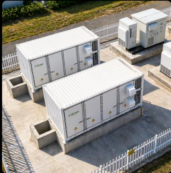
5MWh 集装箱储能 中国浙江 规模 5MW/10MWh
