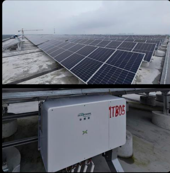
50kW、110kW组串逆变器 中国浙江 规模 2.2MWp
