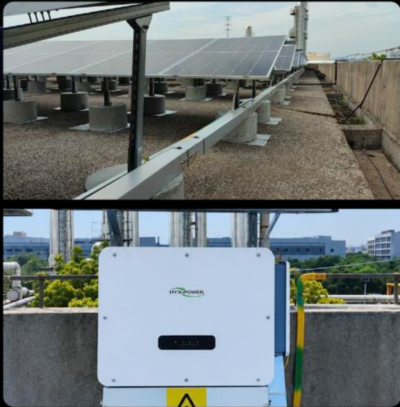
33kW、50kW、110kW 组串逆变器 中国浙江 规模 3.23MWp
