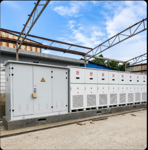
105kW/232kWh 一体柜 中国广东 规模 2.5MW/5.22MWh
