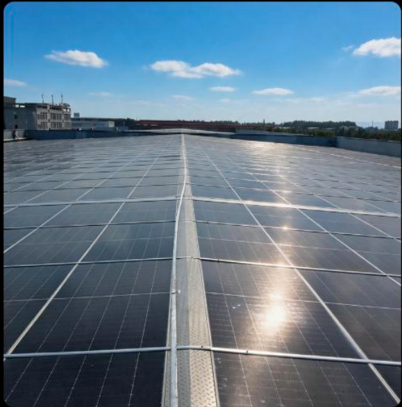
120kW、320kW 组串逆变器 中国华东 规模 30MWp
