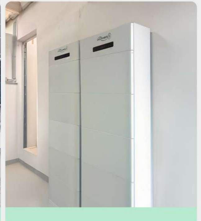
Onduleur Hybride, Batterie Haute Tension Bad Neuenahr-Ahrweiler, Germany Capacité 50kW/50kWh
