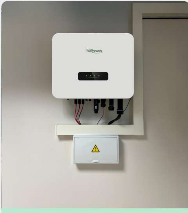
Inversor Híbrido Lleida, Espanha - Capacidade: 25 kW
