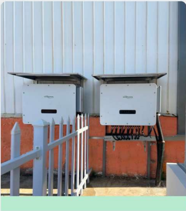
Inversor String de 320 kW Shandong, China, Capacidade 6 MWp
