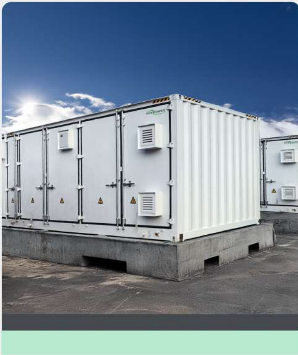
ESS 5000 kWh Zhejiang, China - Capacidade: 400 MWh
