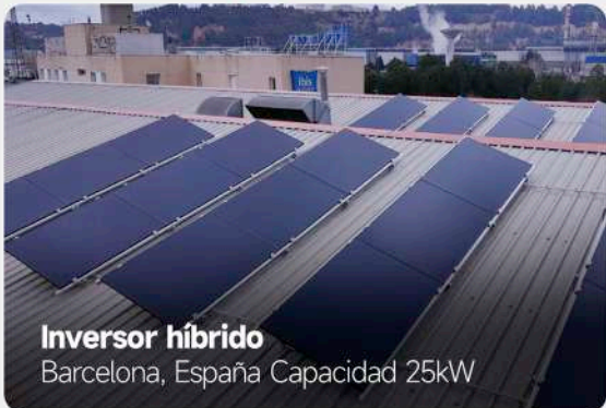
Inversor híbrido Barcelona, España Capacidad 25kW
