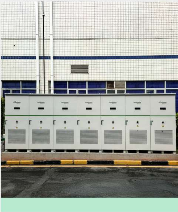
ESS de Resfriamento Líquido de 105 kW/232 kWh Guangdong, China - Capacidade: 3,25 MW/7,19 MWh
