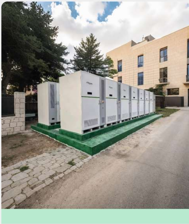
ESS de Resfriamento Líquido de 105 kW/232 kWh Guangdong, China - Capacidade: 2,32 MW/4,64 MWh
