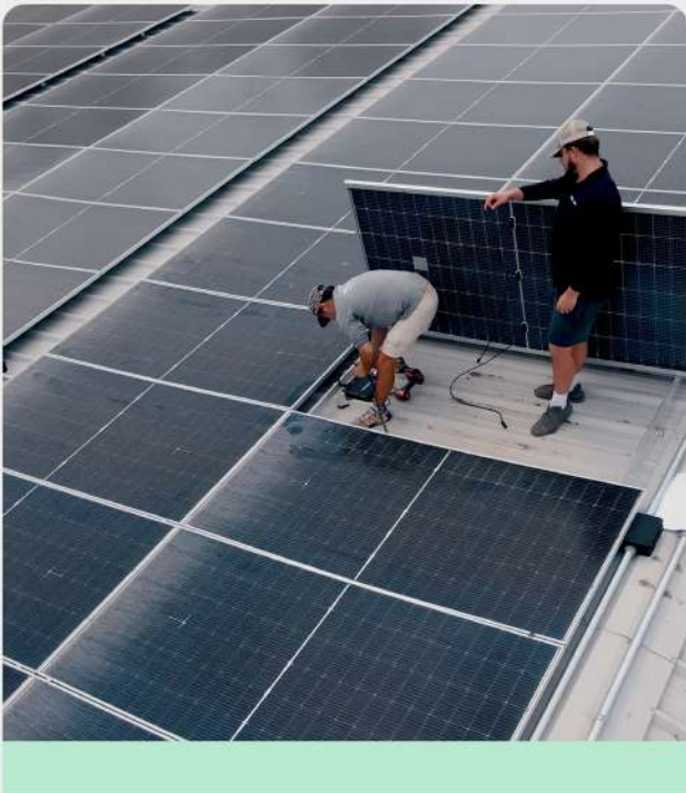
Microinversores 4 em 1 e 2 em 1 Nacogdoches, Texas, EUA - Capacidade: 117 kW
