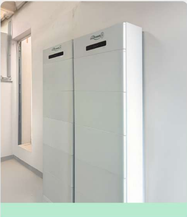
Inversor Híbrido, Bateria de Alta Tensão Bad Neuenahr-Ahrweiler, Alemanha - Capacidade: 50 kW/50 kWh
