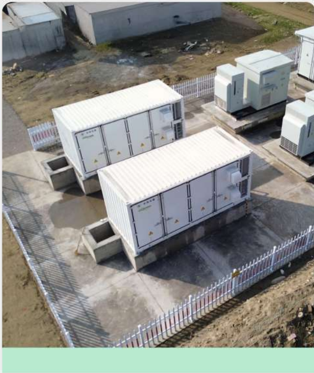
ESS 5000 kWh Zhejiang, China - Capacidade: 5 MW/10 MWh
