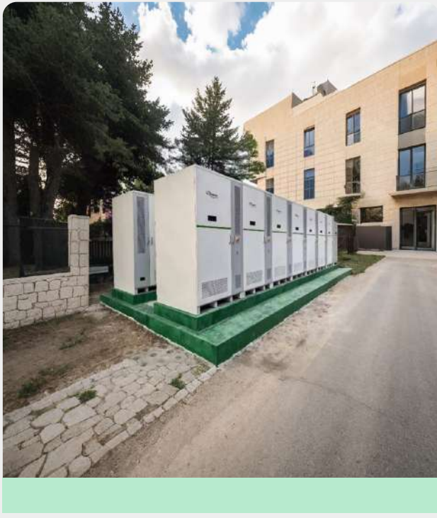
105kW/232kWh 一体柜 广东深圳 规模2.32MW/4.64MWh
