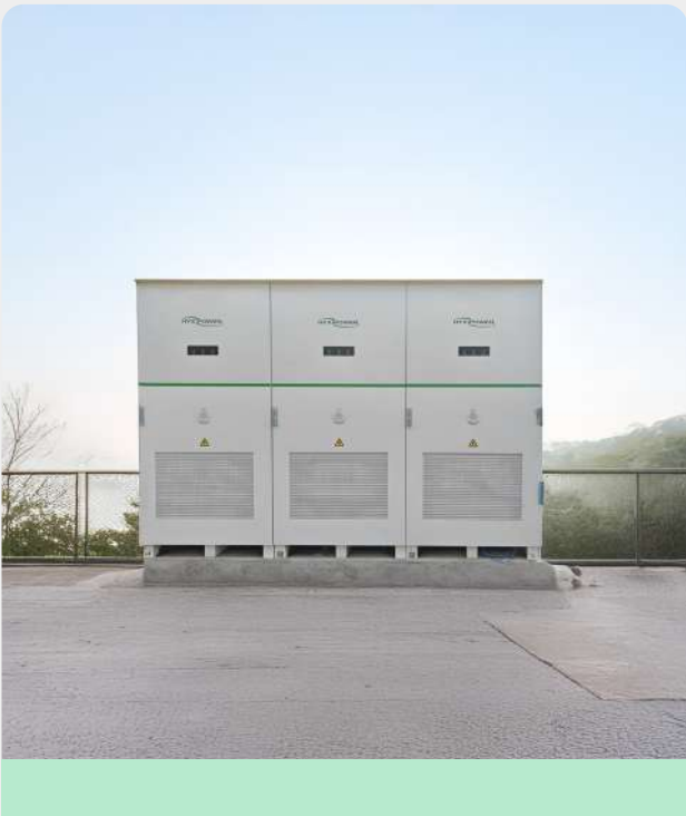
105kW/232kWh 一体柜 江苏南通 规模1.15MW/2.5MWh
