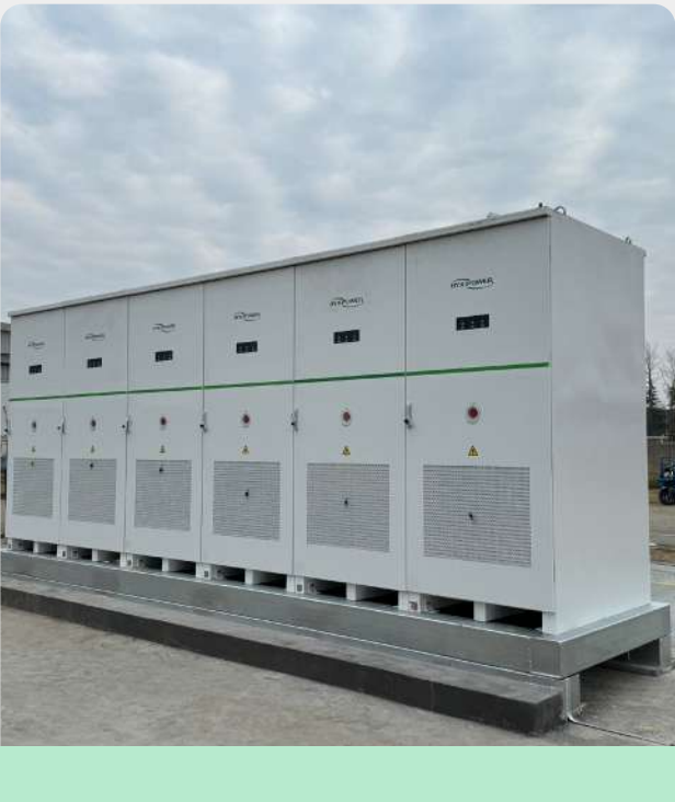
105kW/232kWh 一体柜 江苏昆山 规模0.63MW/1.4MWh
