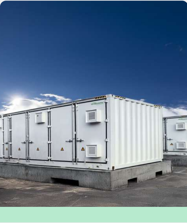
5000kWh 集装箱 中国浙江 规模400MWh
