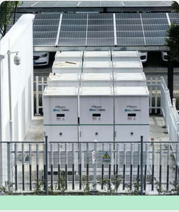
105kW/232kWh 一体柜 浙江杭州 规模1.26MW/2.78MWh
