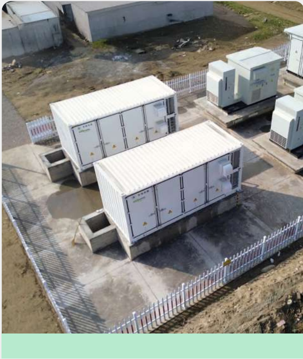
5000kWh 集装箱 浙江杭州 规模5MW/10MWh
