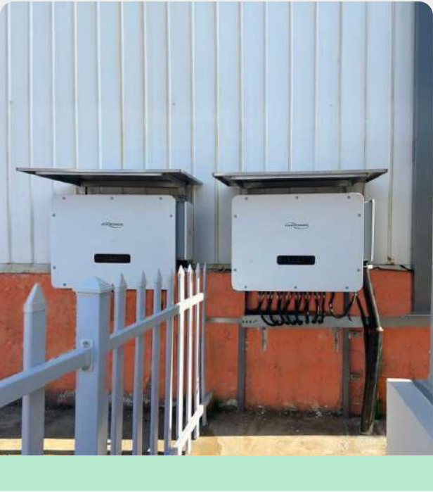
320kW 逆变器 山东高密 规模6.0MWp
