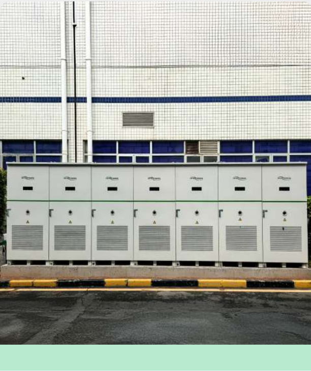
105kW/232kWh 一体柜 广东惠州 规模3.25MW/7.19MWh
