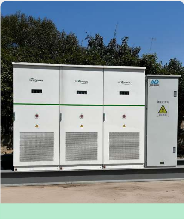
105kW/232kWh 一体柜 浙江宁波 规模1.26MW/2.78MWh
